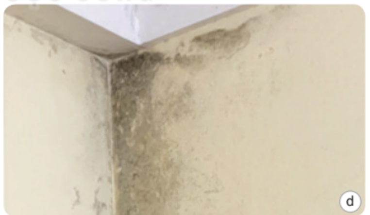
Nấm mốc ở góc tường nhà
