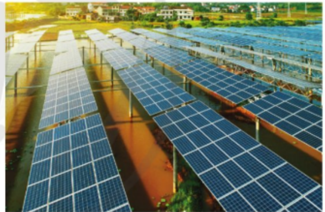
Hình 12.4. Nhà máy điện mặt trời
